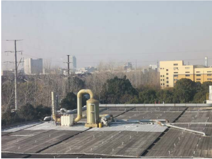
废气处理设施
